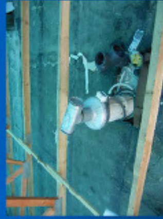
Luftungsprovisorium während der Bauphase
